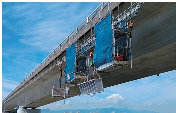
ラックレール式移動吊足場
