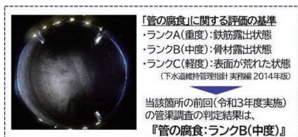
陥没箇所の点検結果
