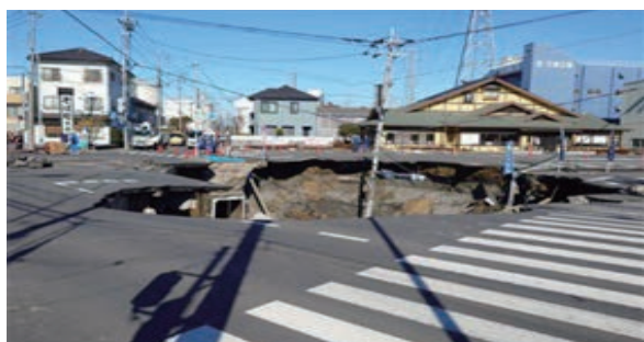
八潮市中央一丁目交差点の陥没拡大状況
