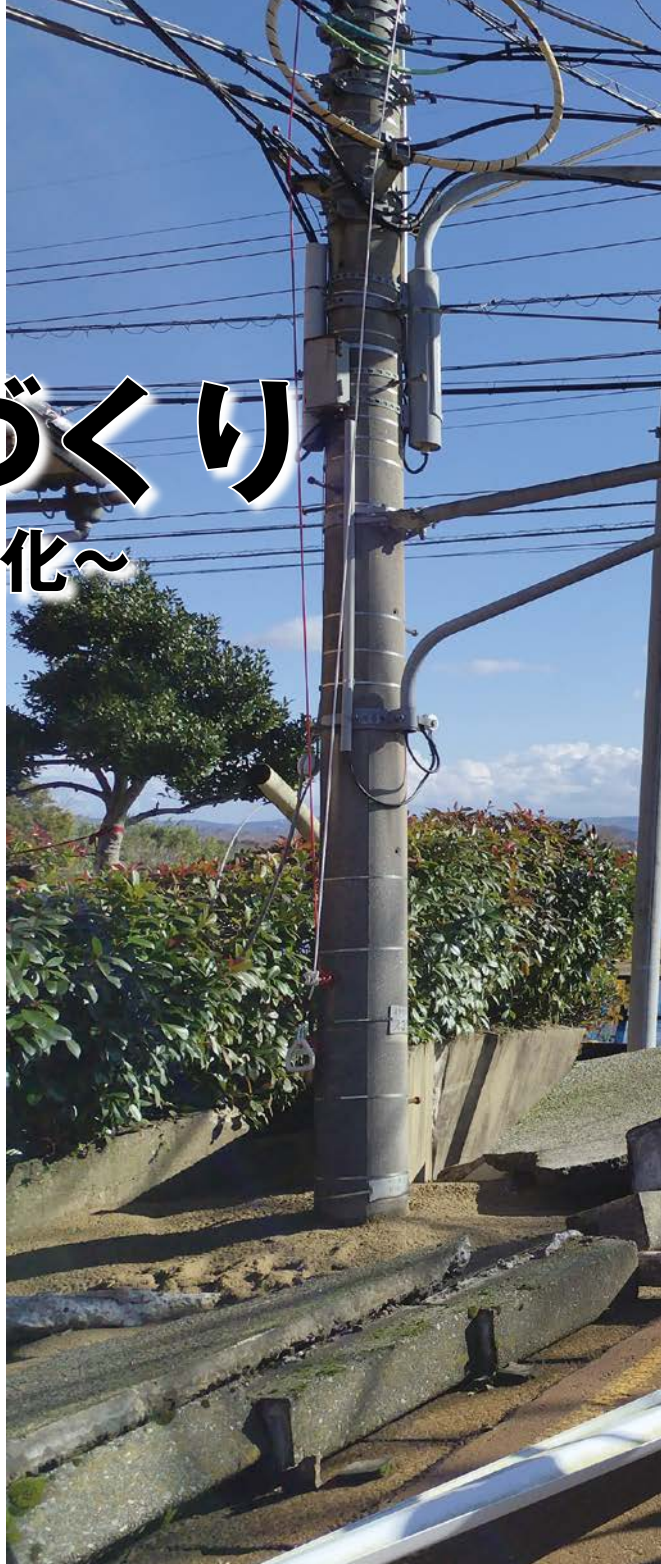
2024年1月4日 能登半島地震で甚大な液状化被害を受けた石川県内灘町西荒屋地区におけるTEC-FORCE(テックフォース)による被災状況調査 国土交通省TEC-FORCE撮影
