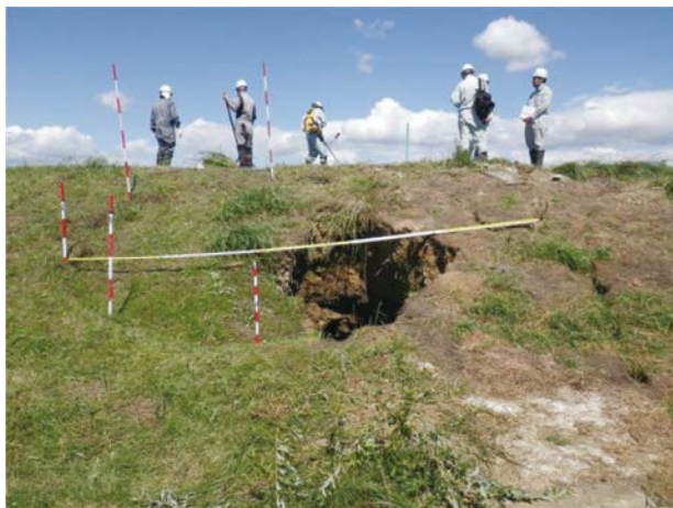
写真-1 堤防陥没状況
