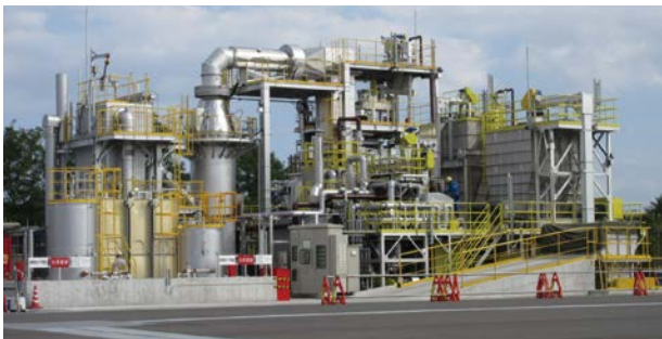
写真-4 共同研究者が設置した実験焼却炉
