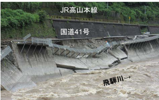
写真-3 道路崩落 近景
