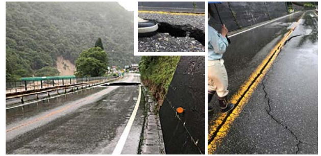
写真-4 道路崩落 初期
