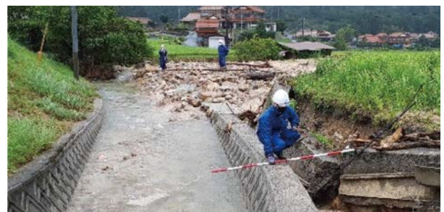
写真-8 河川の被災状況調査（広島県北広島市）
