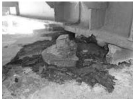
写真-4 支承部の損傷状況
