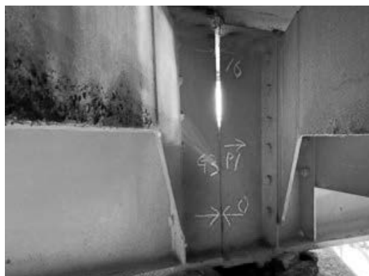
写真-5 遊間異常（主桁同士の接触）
