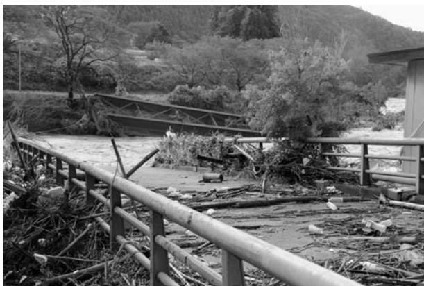
写真-1 転覆した高地原橋
