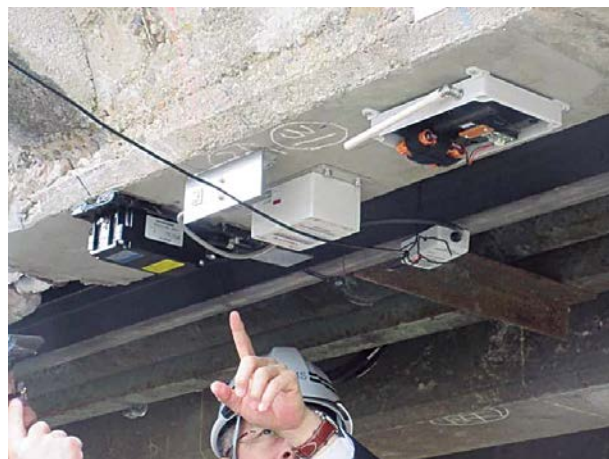
写真-1 センサーの設置状況
