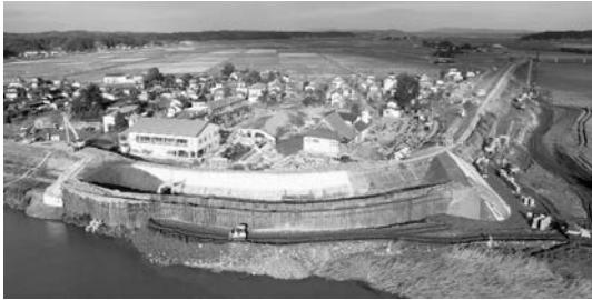
写真-4 堤防決壊から2週間で完了した二重の仮堤防 (写真提供・北上川下流河川事務所)
