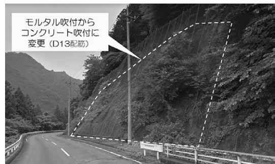
写真-2 4分から8分まで崩落した法面
