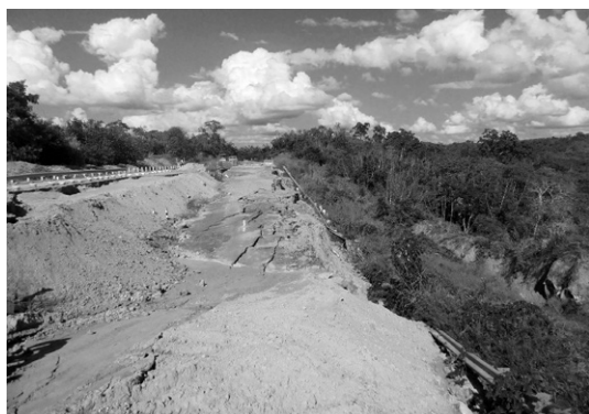
写真-1 崩壊した山岳道路の様子
