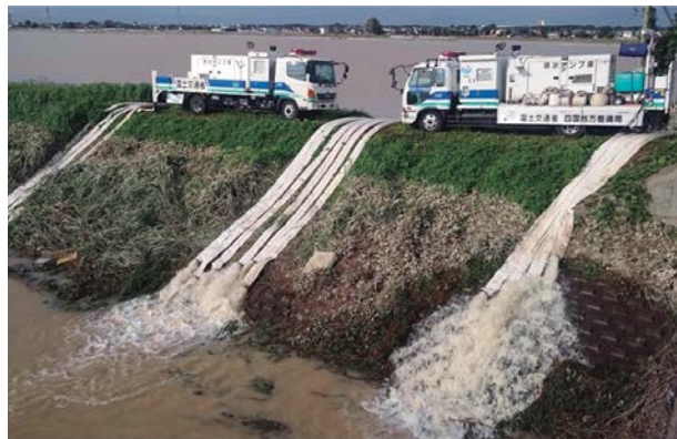
写真-2 排水ポンプ車の稼働状況
