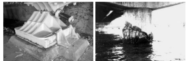
写真-4 支承の破損
