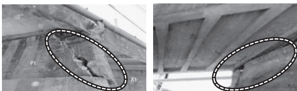
写真-2 洪水による被災 (橋脚のせん断破壊及び上部工床版下面のひび割れ)
