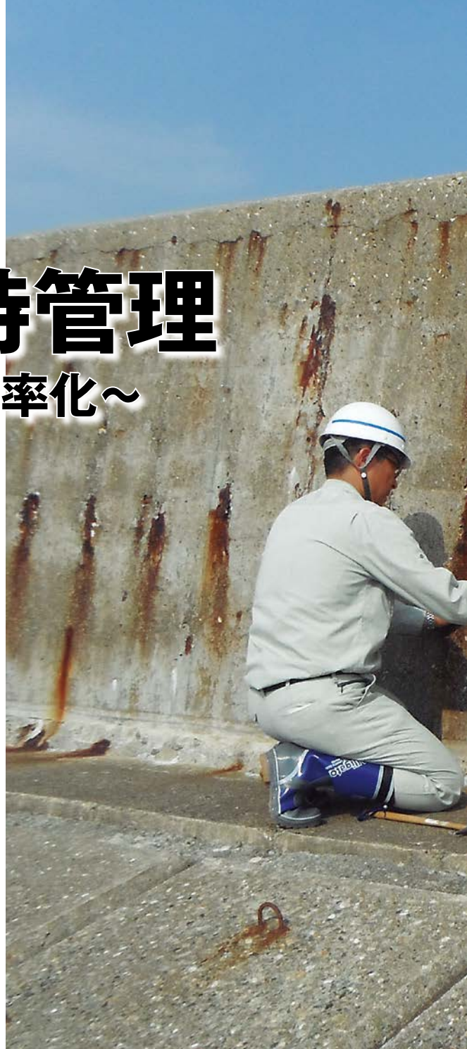
コンクリートが劣化し鉄筋が露出した海岸保全施設 (本号 P22～24「海岸保全施設の老朽化対策の最新の動向」より)
