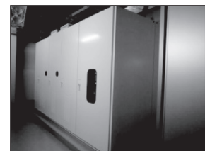
電源施設の浸水対策（2階に設置）
