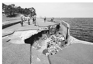
写真－1 想定以上の高波による横浜港金沢地区福浦の護岸倒壊状況（台風第15号）
