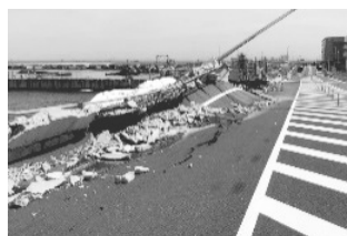
写真－2 走錨した船舶の衝突による横浜港南本牧はま道路の損傷状況（台風第15号）
