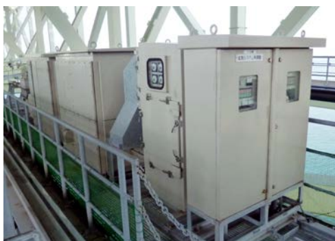
送気用機械設備
