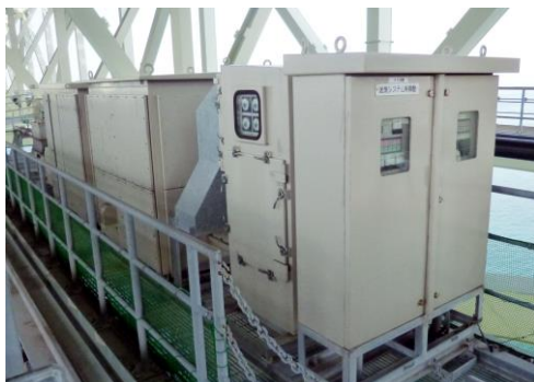
送気用機械設備
