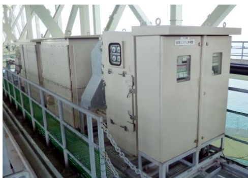
送気用機械設備
