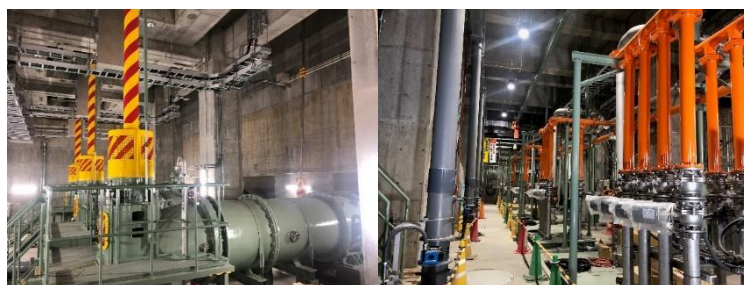
写真-3 雨水ポンプ設備
