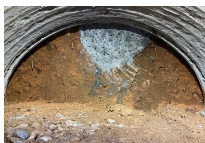
写真-2 切羽に出現した玄武岩の一部 終点坑口から20m付近
