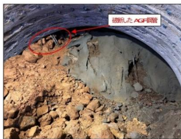
写真-1 層境掘削時の大崩落状況(TD81m 付近)
