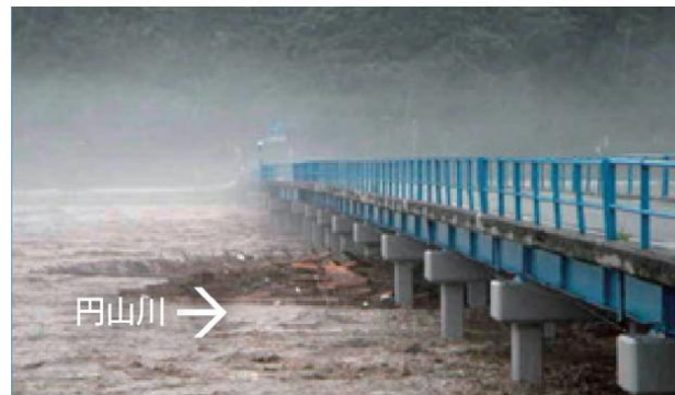
【平成 21 年台風 9 号による状況】
