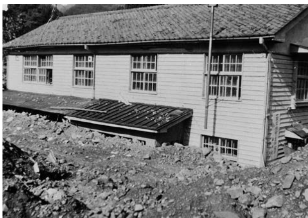
昭和40年奥越豪雨による西谷村の土砂災害
