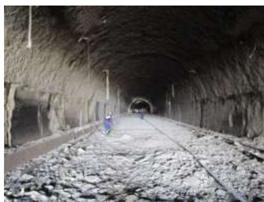
写真-4 発災直後の尼子山トンネル
