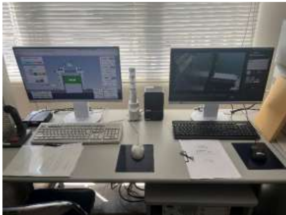
水門遠隔操作監視システム設備 (左:遠隔操作端末、右:遠隔監視端末)
