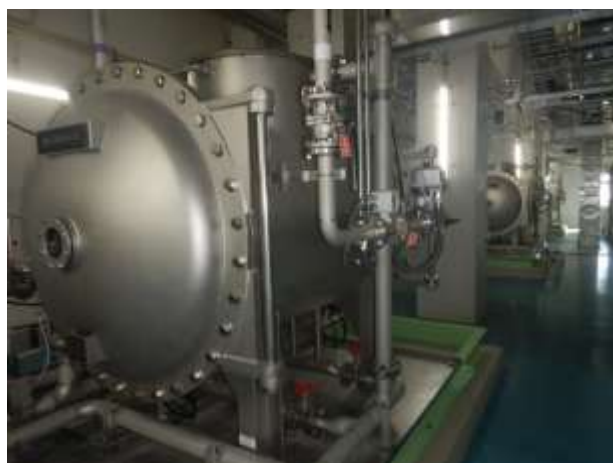
オゾン発生装置
