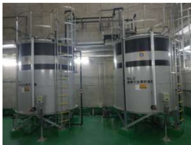
過酸化水素貯留槽
