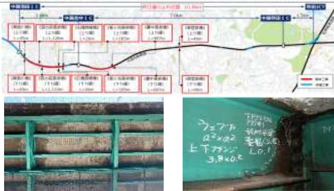
対象橋梁とその劣化状況
