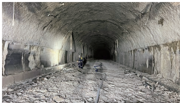
鎮火後の尼子山トンネル坑内
