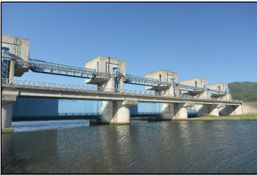
水門・陸閘は自動的に閉鎖される
