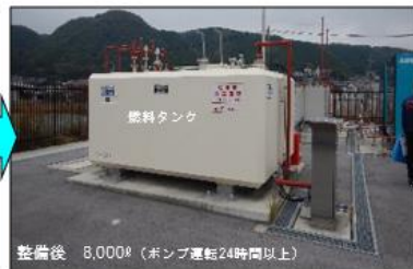
整備後 8,000ℓ (ポンプ運転24時間以上)
