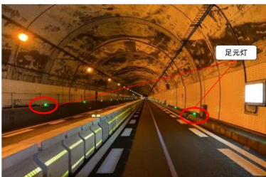
写真-5 足元灯の点灯状況
