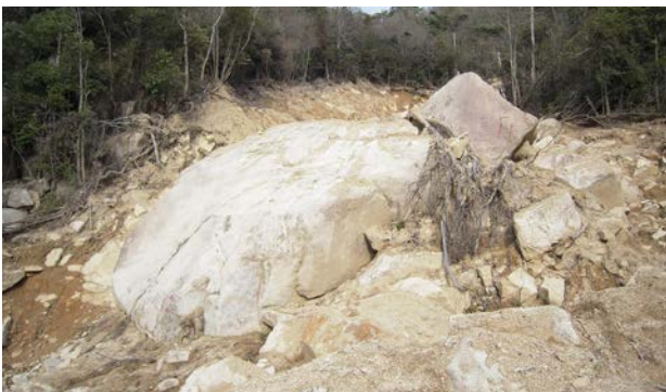
斜面に残った不安定なコアストーン
