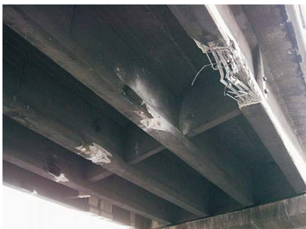
主桁損傷状況（右からG1桁～G5桁）
