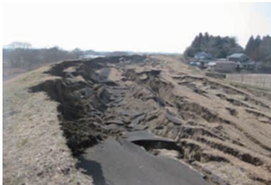
堤防被災状況
