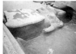
床止ケーソンの欠損・摩耗状況
