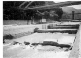
帯工等の欠損・摩耗状況
