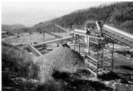
盛立材料製造設備全景
