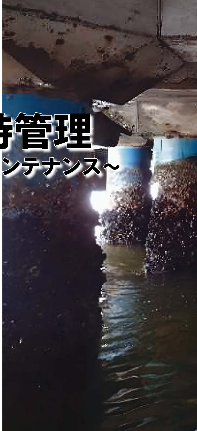
タブレット等の移動端末を活用した点検診断 (本号P25～27「港湾施設の老朽化対策の取組」より)
