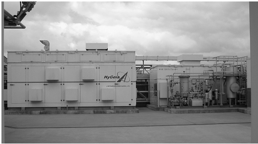
写真-2 水素製造設備
