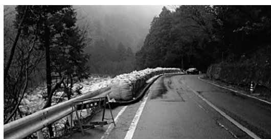
写真－2 県道湯の山温泉線で発生した道路陥没
