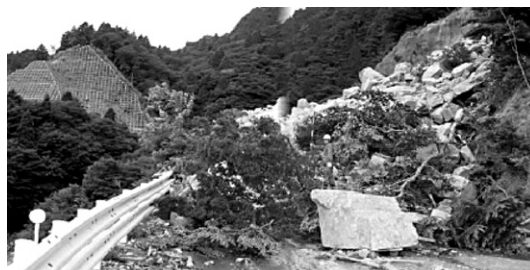
写真－3 国道477号で発生した法面崩落
