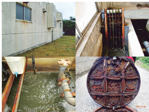
写真-1 施設の劣化状況
