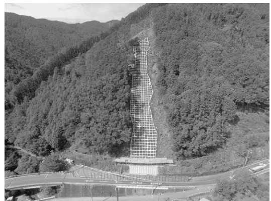
災害復旧状況（交通開放 R1. 10. 17）
