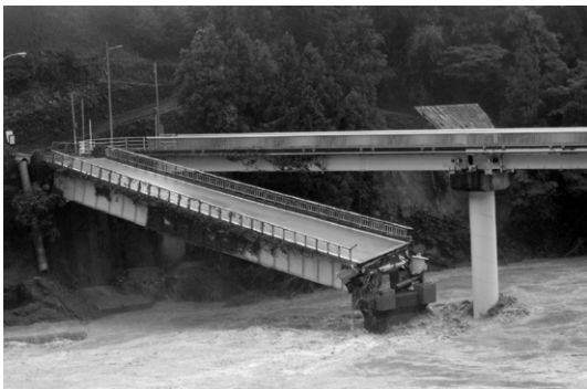
写真-3 国道168号折立橋橋梁落橋
