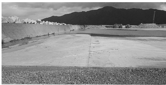
野積場着工前(地盤沈下により路面排水機能を損傷)
