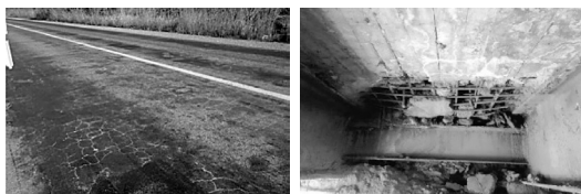
写真-1 損傷事例（舗装・RC床版橋）
