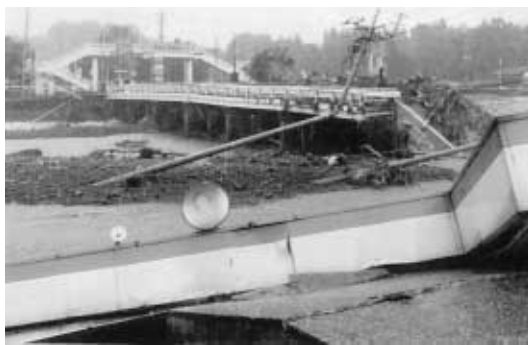
被災時 国道4号余笹橋
