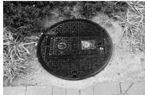
災害時にはトイレとして利用可能なマンホール蓋
