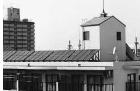
集会室へ電力を供給する太陽光発電システム
